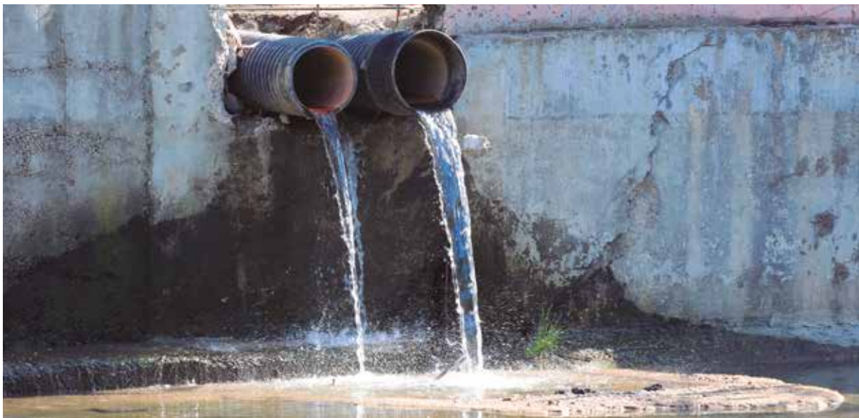
Vertido de aguas residuales
