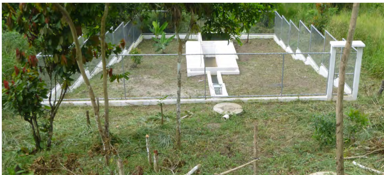
Instalación de saneamiento en Chilla, Ecuador
