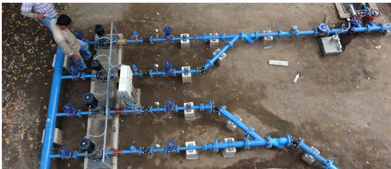
Estación de bombeo en El Salvador
