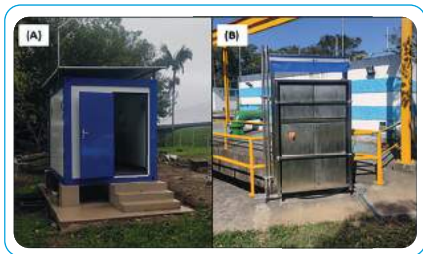
Figura 8.8. Estructuras de protección para estaciones automáticas: (A) Contenedor de la Estación Automática Río Grande/CETESB; (B) Gabinete de la Estación Automática Pindamonhangaba/CETESB.
